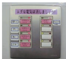
電気使用量の削減(照明スイッチ)
