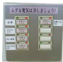
電気使用量の削減(照明スイッチ)
