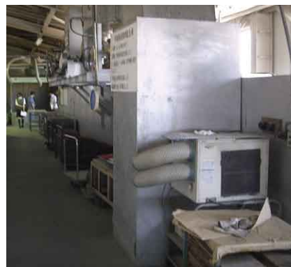
触媒燃焼式脱臭装置
