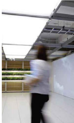
会議開催前に自動的にLED照明点灯
