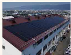
太陽光発電システム
