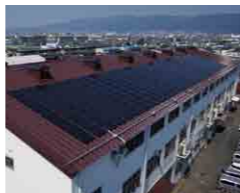
太陽光発電システム
