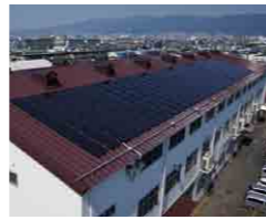
太陽光発電システム
