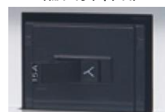
ブレーカー部 (本体裏側)
